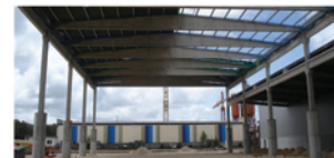
Pré-Fabricado com cobertura em chapa metálica
